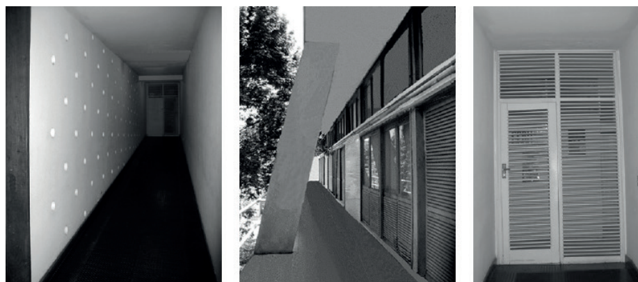
Figura 13. Cerramientos empleados en las casas Fuente: Reconstrucción virtual realizada por Ivanilson Pereira con base em redibujo em Autocad de Alcilia Afonso. 2020.
