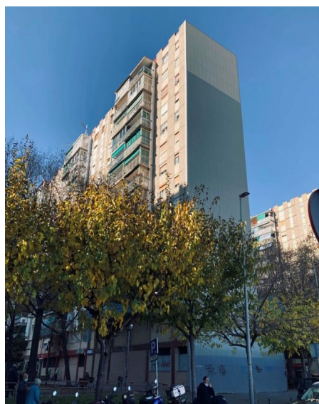
Figura 13: Se ha procedido a aislar los testeros por el exterior. Robert Terradas (2020)
